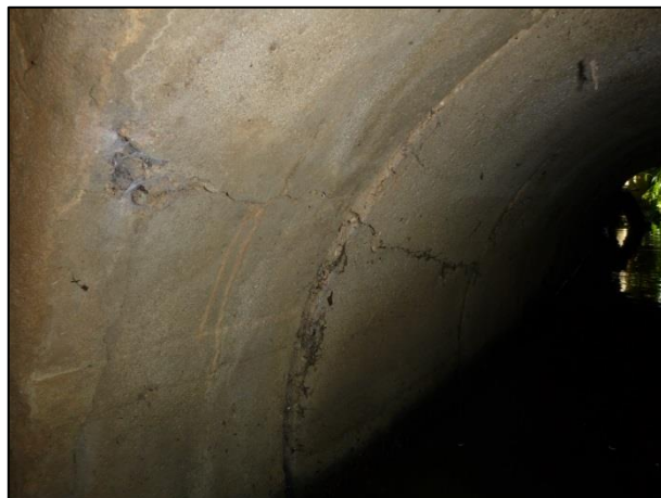
PM4 – Fissure longitudinale à 10h (5 mm) avec rejet (4 mm)
