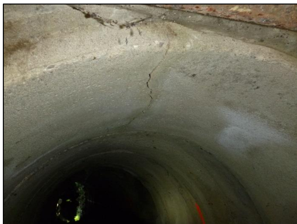
PM1 - Fissure longitudinale en clé (4 mm)
