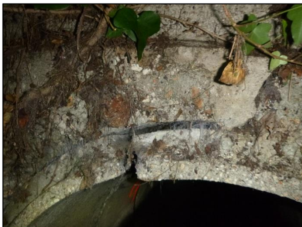
Aval – Vue de l'extrémité de la fissure à 1h
