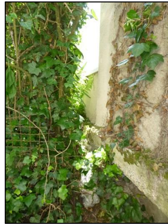
Détail vue de l'extrémité amont : impact clôture riverain côté gauche
