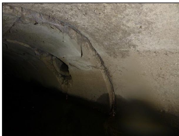
PM7 – Raccordement de branchement obstrué à 9h
