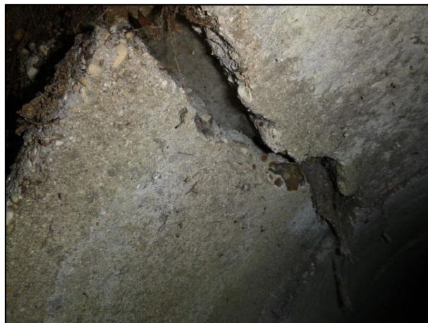
PM7,9 – Fissure longitudinale à 1h (40 mm) avec rejet (20 mm)
