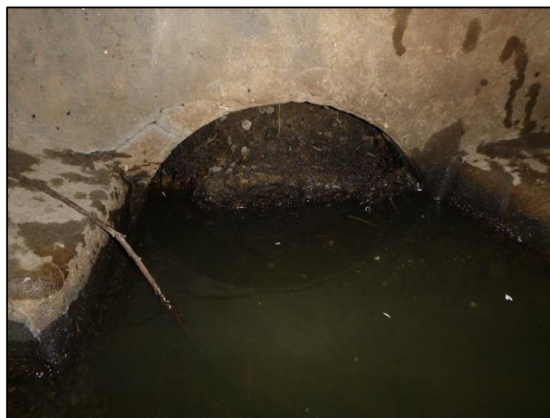
PM2,5 - Raccordement de branchement obstrué côté gauche
