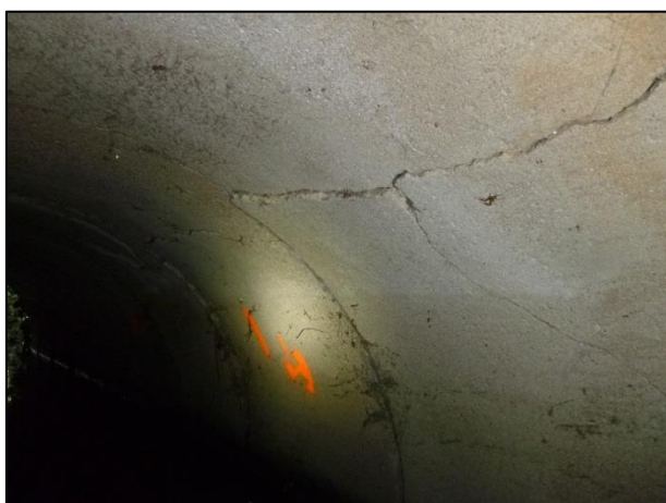
PM4 – Fissure longitudinale à 1h (9 mm) avec rejet (7 mm)
