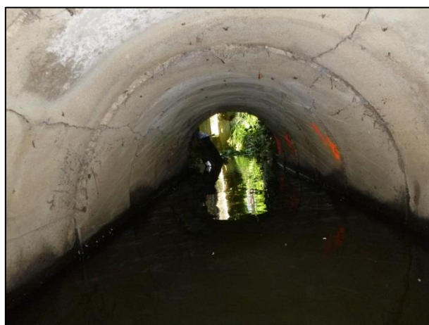
PM5 – Vue générale vers l'aval : multi-fissuration ouverte
