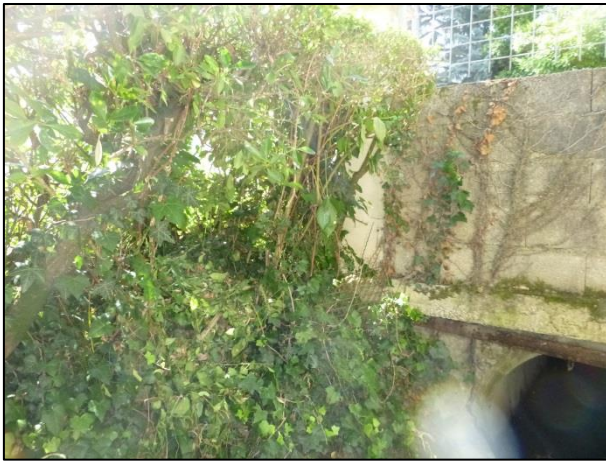
Vue de l'extrémité amont : impact clôture riverain côté gauche
